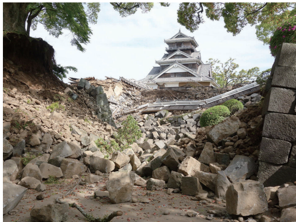
崩壊した石垣(宇土櫓南、頬当御門周辺)
