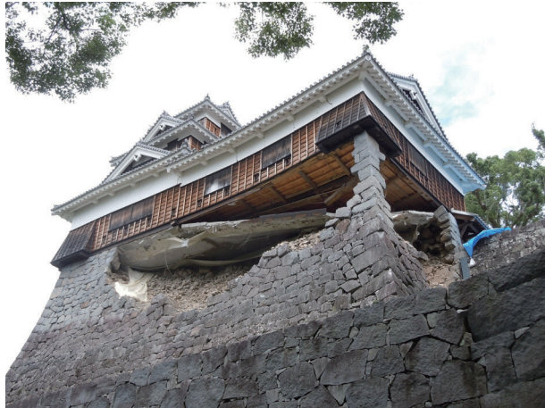
被災した飯田丸五階櫓（奇跡の一本石垣）
